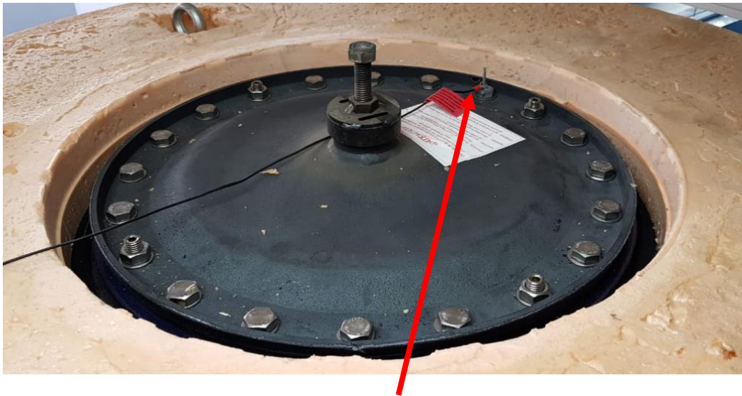
Conexión cable a masa tapa superior del acumulador
